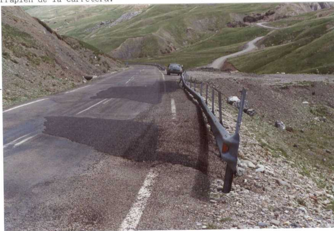
Fotografía n.º 6.: Vista del desplazamiento horizontal sufrido por la calzada y de los rellenos precisos de forma periódica para suavizar el escalón producido por las grietas laterales del deslizamiento (Situación A).
