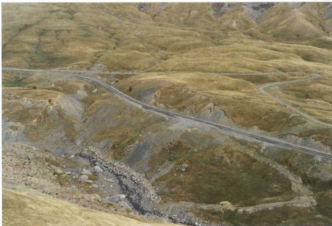
Fotografía n.º 2.: Panorámica del tramo concreto afectado. Aprecie se el badén por las marcas más oscuras que aparecen en la calzada y por la deformación en las vallas de protección.
