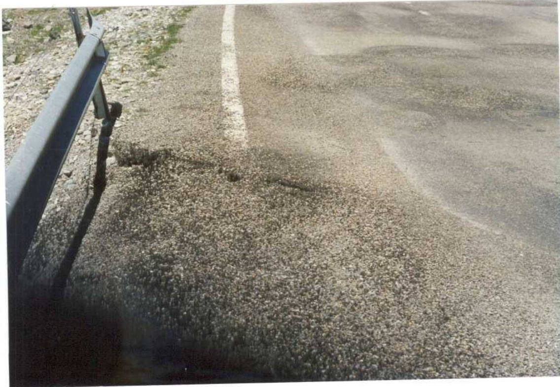
Fotografía 3. Detalle de la grieta sobre la calzada en el costado derecho del deslizamiento (Situación A).
