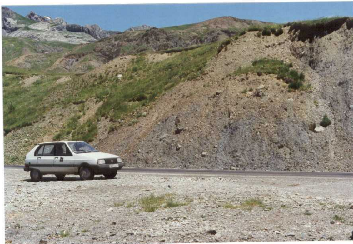
Fotografía n.º 5 .: El deslizamiento superficial de ese pequeño talud produce represamientos en la cuneta interior de la carretera agravando progresivamente el problema de socavamiento. Por filtraciones del terraplén de la carretera.
