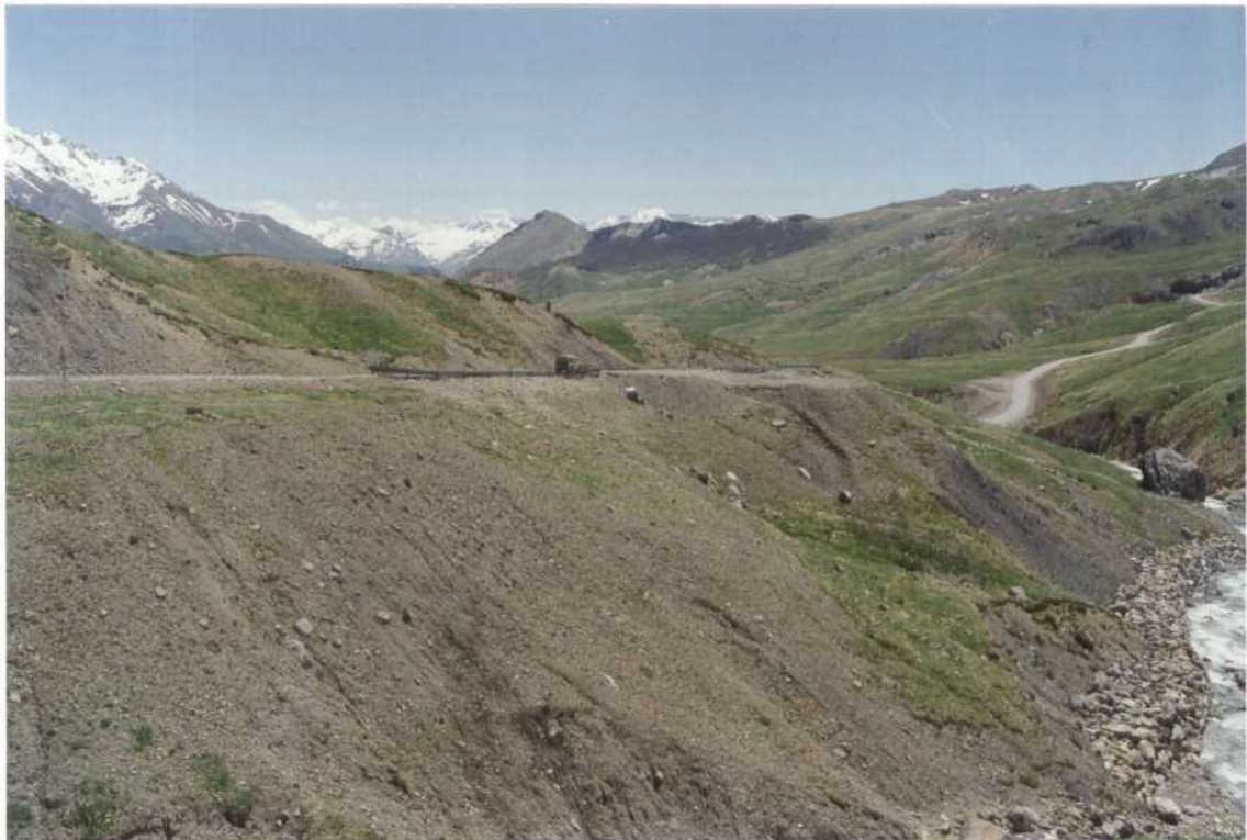
Fotografía n.º 8.: Vista del terraplén de la carretera y de las defensas de escollera puestas para evitar que el fenómeno progrese. Véase justo por encima del escollerado la masa deslizada, que coincide con el inter va lo de carretera afectada, y que ha sido erosionado progresivamente en su proceso de descenso por el río.
